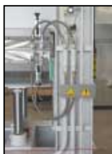
Impianto di riscaldamento Heating system Heizkreisanschlüsse
